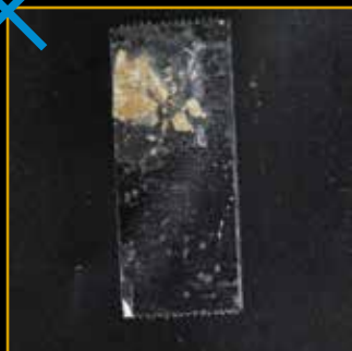
劣化着色層剥離 塗装不可
