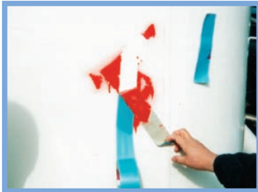
歩道橋橋脚の落書き
