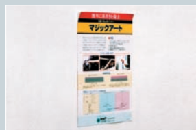
貼り紙の端が浮き上がっている。
