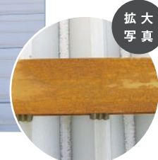
鉄骨の表面に赤さびが発生
