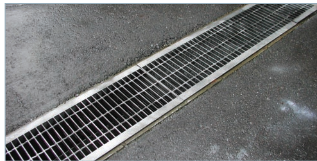
グレーチング(溝蓋)
